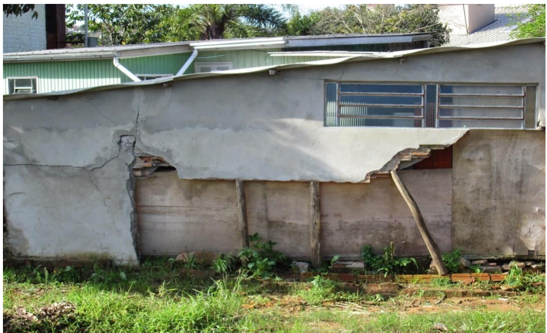
Figura 3: casa que teve a parede rompida e os móveis levados pela água.
