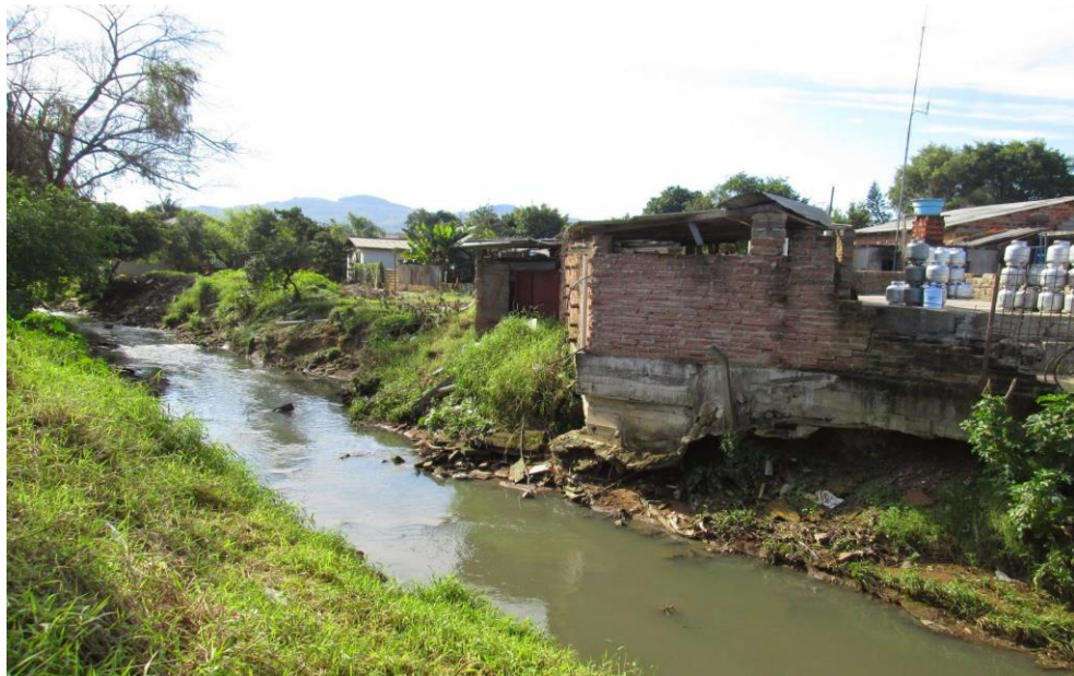
Figura 2: Moradias no entorno do Arroio Pampa.
